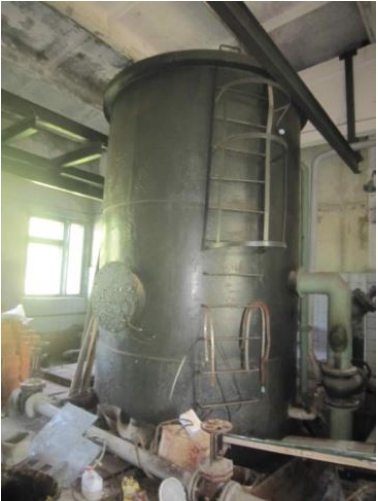
Рисунок 12. Каркасно-засыпной фильтр блока доочистки сточных вод ОСК г.п. Никольский.
