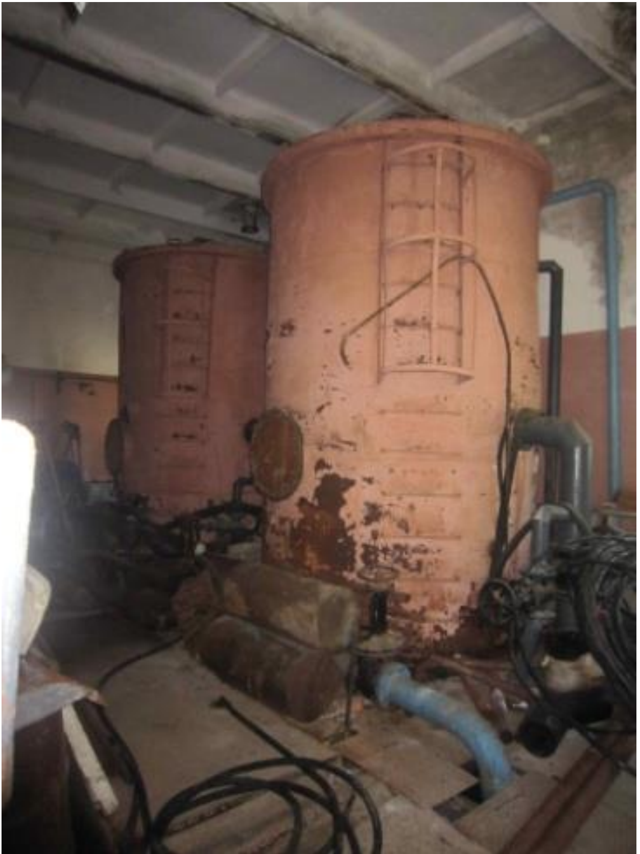
Рисунок 13. Каркасно-засыпной фильтр блока доочистки сточных вод ОСК г.п. Никольский.
